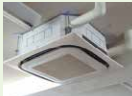
夏季の学習環境の改善のため平成23年に全教室にエアコン設置
